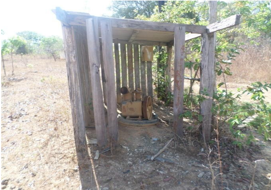
Figura 41- Poço Subterrâneo Santa Maria I
