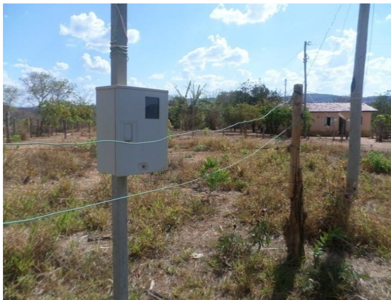
Figura 31- Padrão sem relógio do poço
