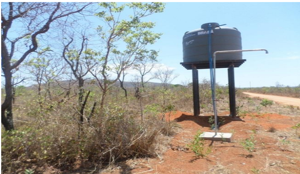
Figura 56-Caixa d'água instalada pela CODEVASF
