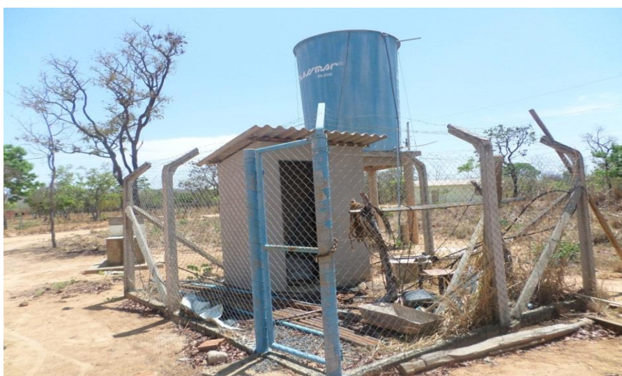
Figura 54- Poço Subterrâneo 01 inativo P.A Boqueirão/Buriti Grosso
