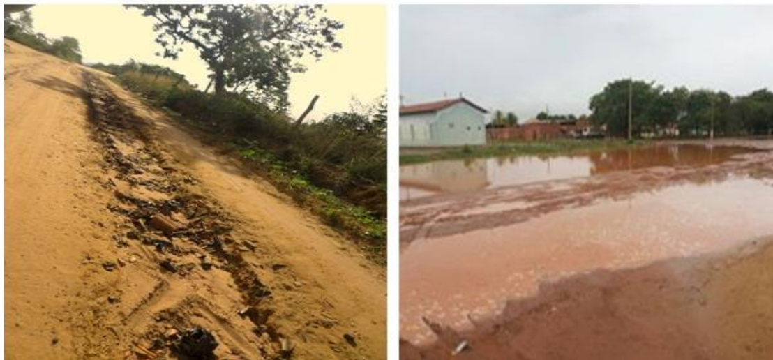
Figura 66 - Ruas sem pavimentação com erosões e alagamentos
