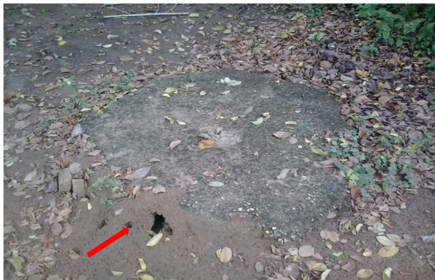
Figura 63 Fossa negra com abertura na tampa, causando mau cheiro.
