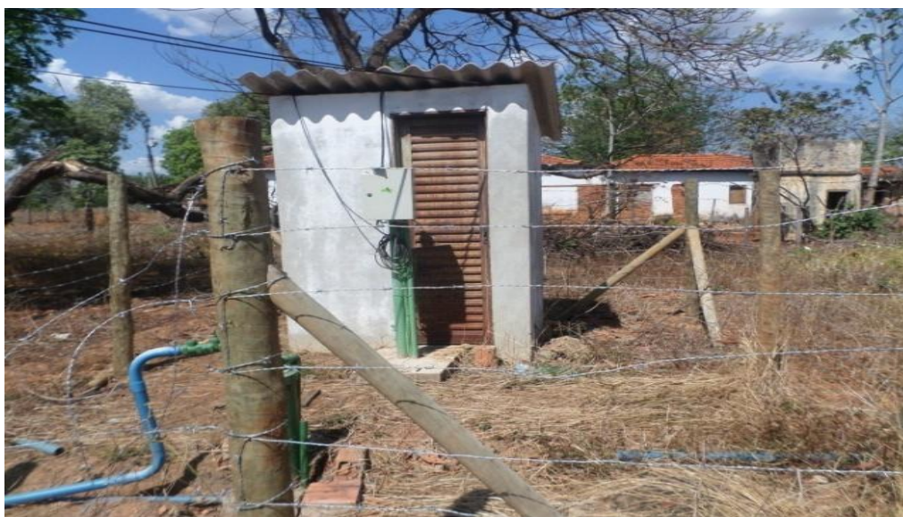
Figura 28- Poço subterrâneo 02 P.A Carlos Lamarca
