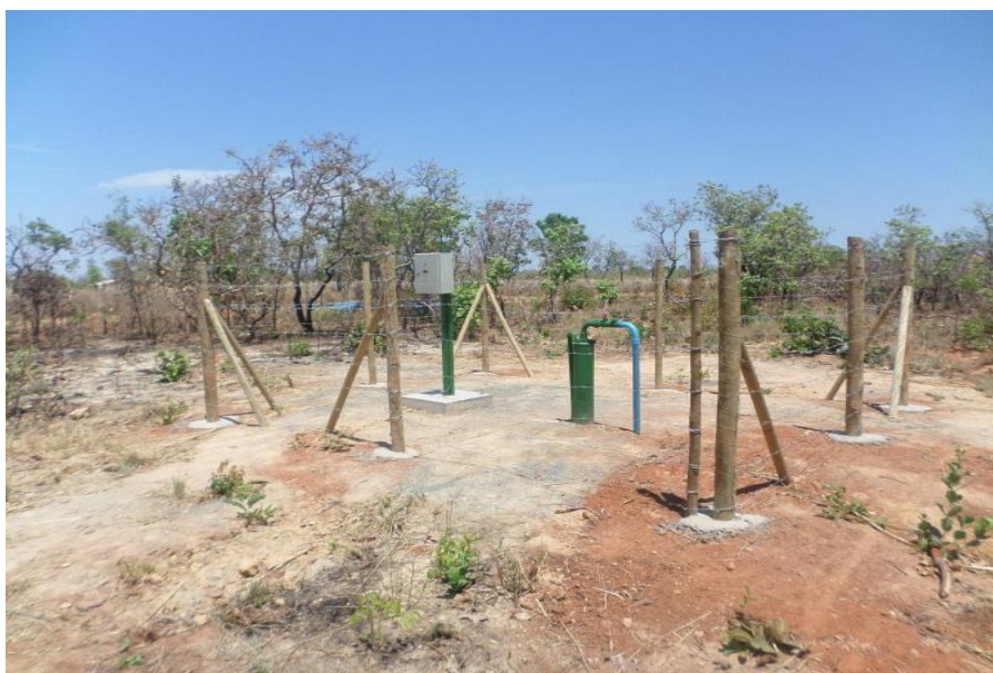
Figura 55-Poço perfurado pela CODEVASF
