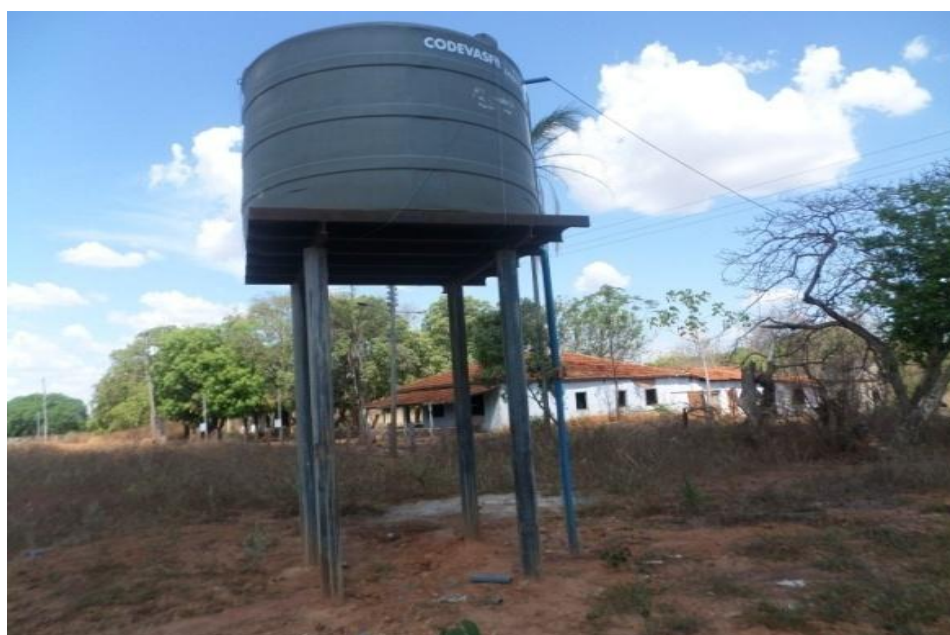
Figura 29- Caixa d'água ligada ao poço
