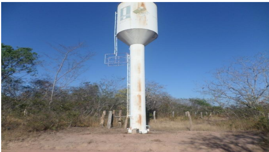
Figura 48- Caixa D'água inativa P.A mimoso
