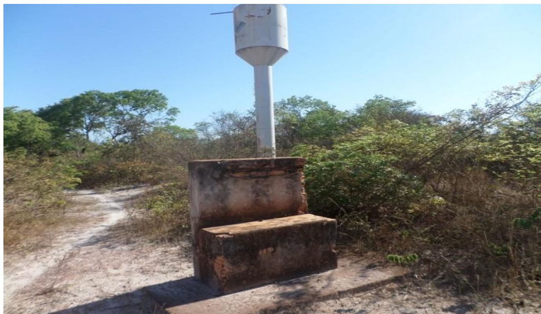
Figura 51- Caixa D'água inativa ao poço inativo
